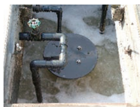
写真-4 油脂分解槽
